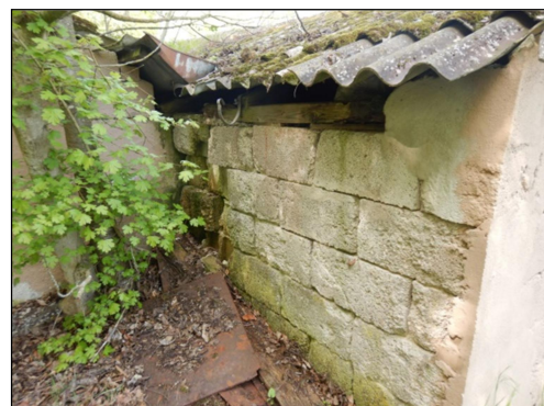
Die Gebäude sind zum Teil in marodem Zustand und es gibt vielerlei Öffnungen und Spaltenräume
